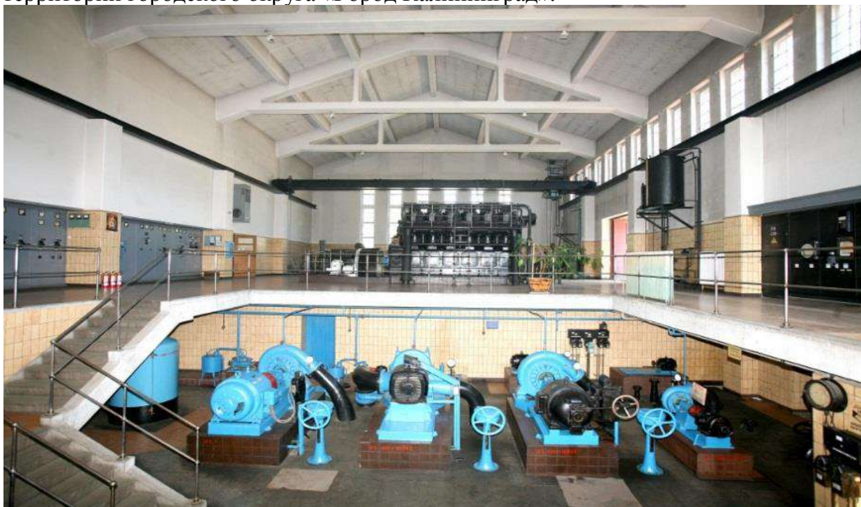
Рис. 3.18. Насосный зал Восточной водопроводной станции
