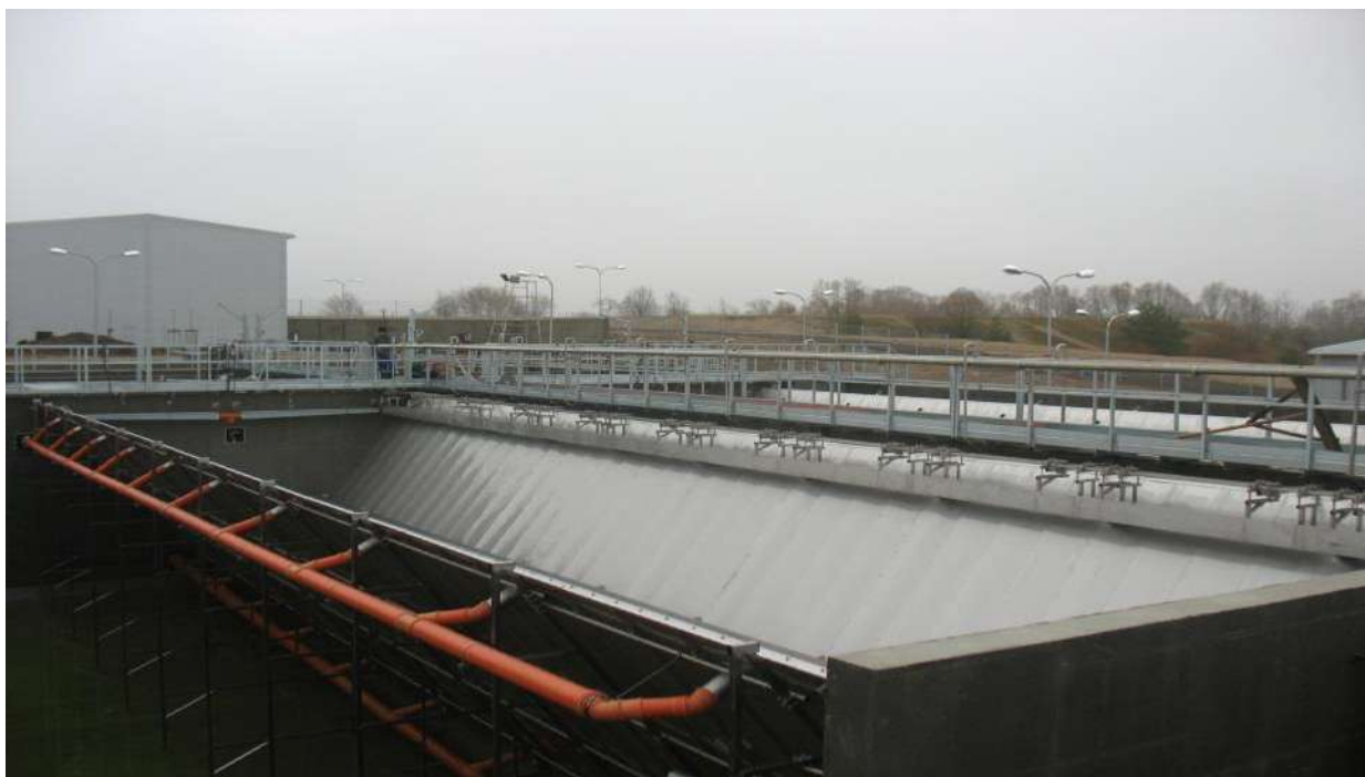
Рис.3.25. Очистные сооружения в городе Немане
