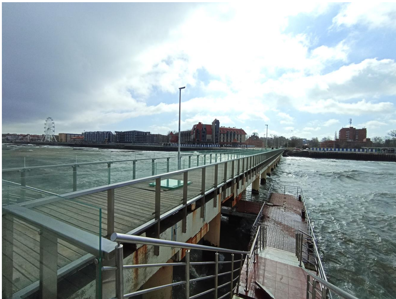
Разные типы покрытия пирса, требующие замены
